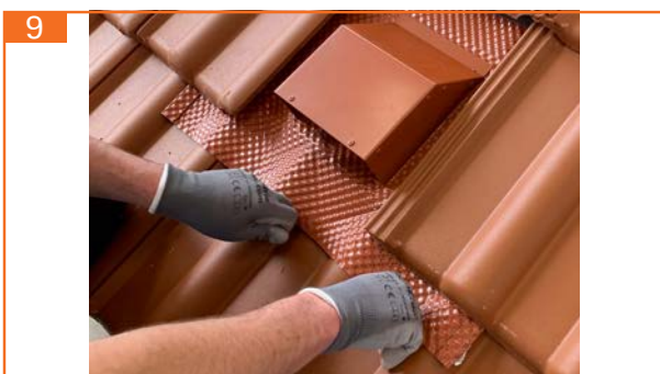
9. Dachhaube an Kontur des Ziegels mittig beginnend nach außen anformen und fest andrücken.
